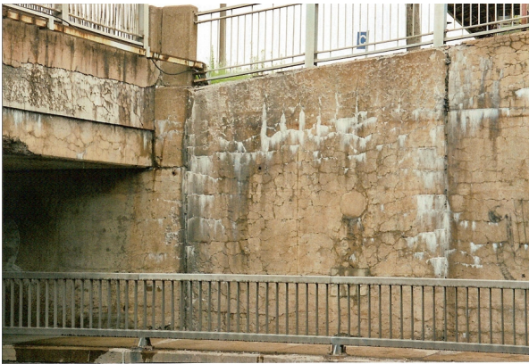
Bild 2.35: Netzrissbildung an einer AKR-geschädigten Straßenunterführung, Alter unbekannt (Canada, 2006)
