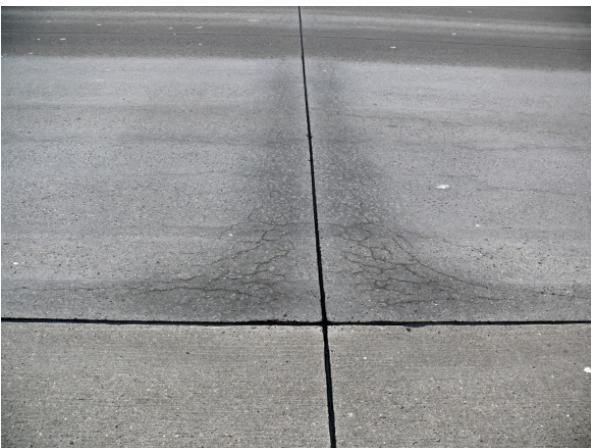
Bild 2.43: Fortgeschrittene Rissbildung (Netzrisse) im Fugenkreuzbereich (Deutschland, 2008)
