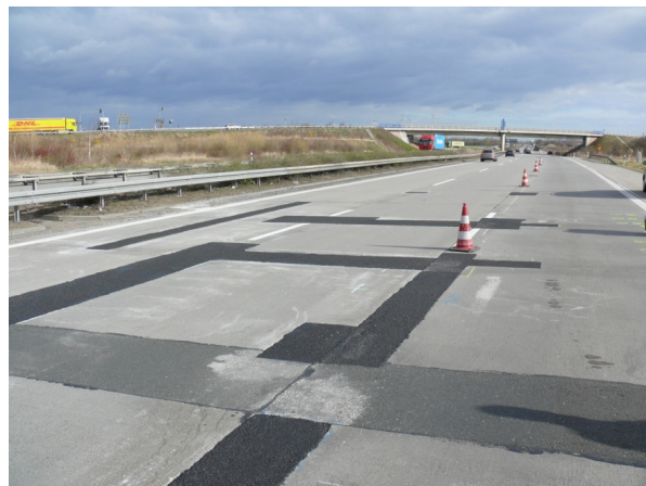
Bild 2.44: Überbau AKR-geschädigter Fugenbereiche mittels Asphaltdeckschicht (Deutschland, 2008)
