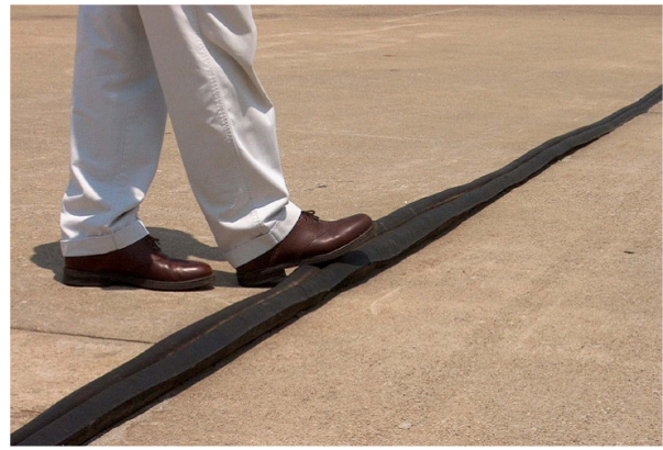
Bild 2.48: Fugenverfüllmaterial wird durch AKR-bedingte Dehnung der Betonplatten einer Flugbetriebsfläche herausgedrückt [126]
