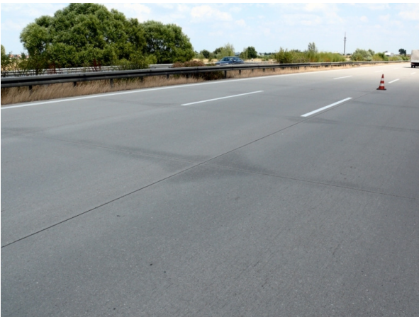
Bild 2.41: Verfärbung von Fugenflanken und -kreuzen einer Betonfahrbahndecke als erste Anzeichen für eine beginnende AKR (Deutschland, 2006)
