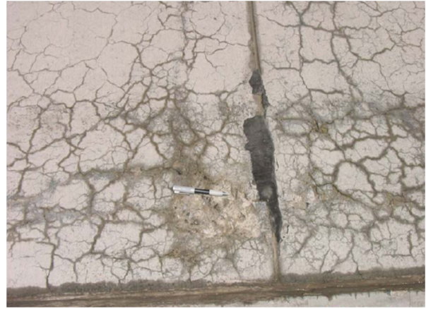
Bild 2.46: AKR-bedingte Netzrisssbildung und erste Ausbrüche im Fugenbereich von Betonplatten einer Flugbetriebsfläche [126]
