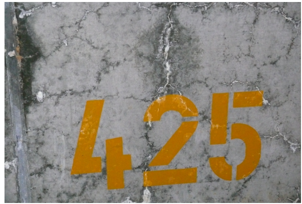
Bild 2.36: Netzrissbildung an einem AKR-geschädigten Tunnel-Tübbing, 17 Jahre alt (Deutschland, 2007)
