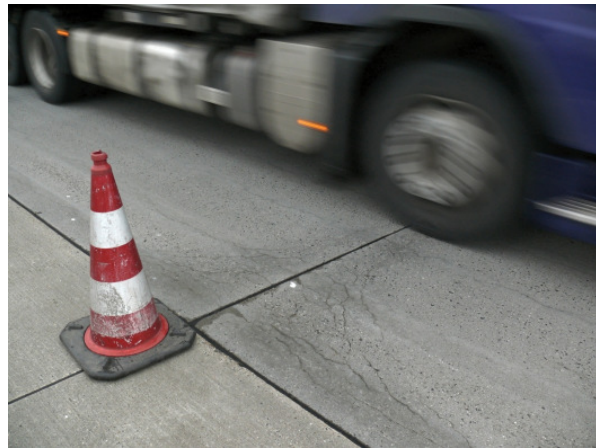
Bild 2.42: Netzrissbildung im Bereich eines dunkel verfärbten Fugenkreuzes als Hinweise auf eine ablaufende AKR (Deutschland, 2008)
